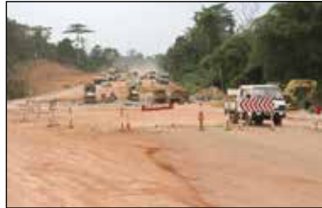
Zerstörung durch Straßenbau
